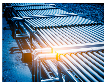
IMPIANTI SOLARI TERMICI
